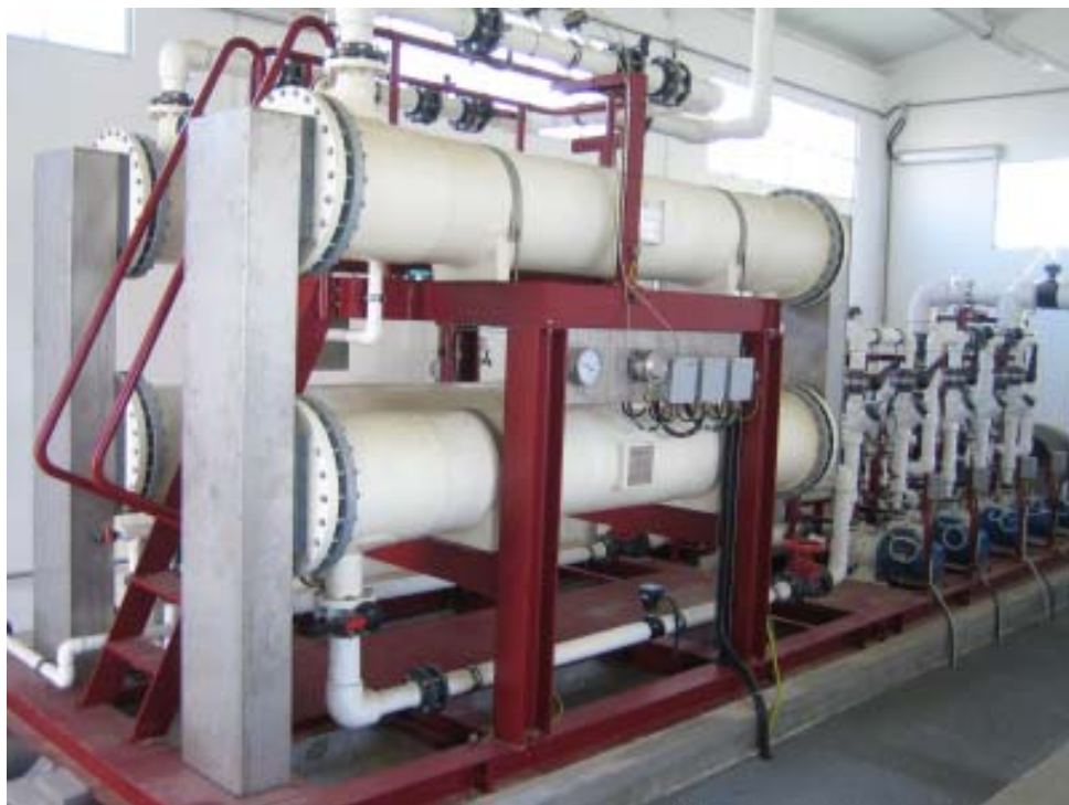
impianti di raffreddamento
