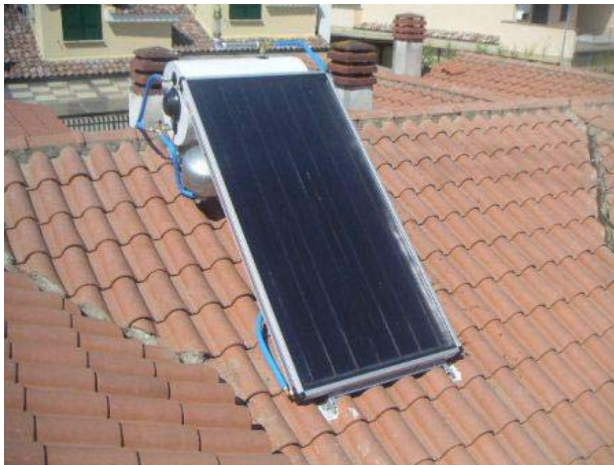
impianti solari termici
